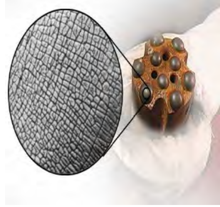
Şekil 4. Kılcal çatlaklar (Mertyurek E.2016)
