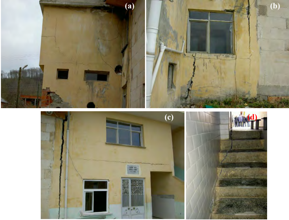
Şekil 5. Binadaki patlatma kaynaklı çatlaklar ve zemindeki oturmadan kaynaklanan çatlaklar
